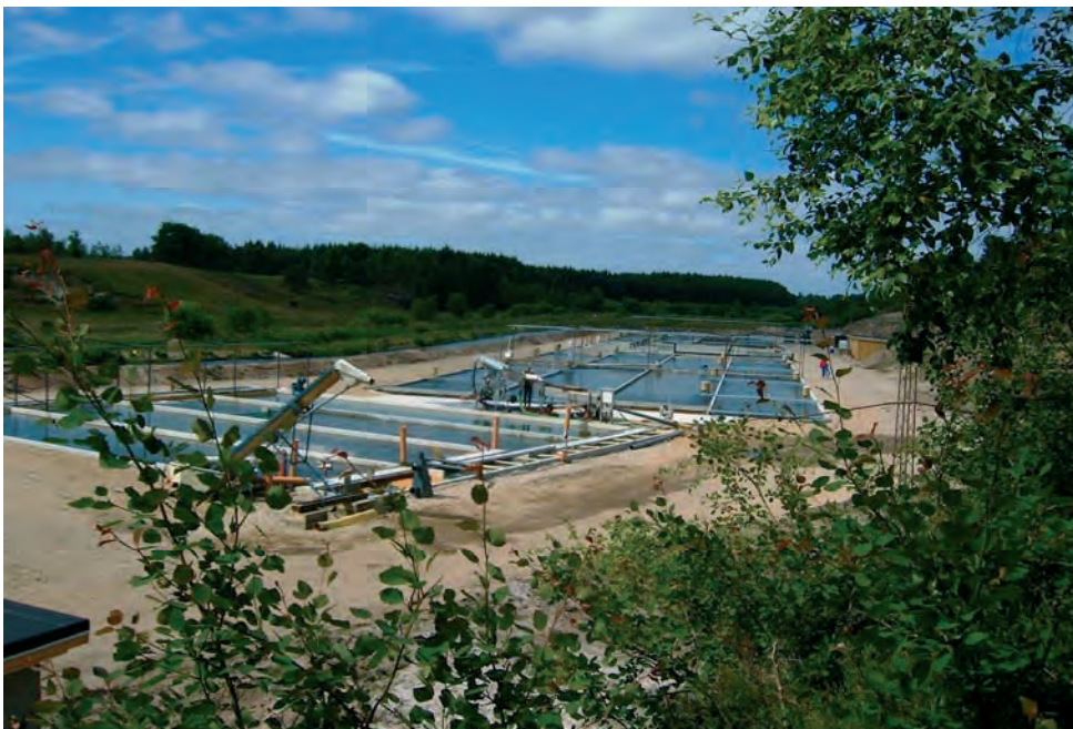
Figur 11. Ejstrupholm modeldambrug type 3. Produktionsanlægget omfatter 2 sektioner hver bestående af 2 beton raceways. I forgrunden 3 betondamme til levering af fisk. I baggrunden til venstre plantelagunerne bestående af de tidligere jorddamme, der nu er begroet med planter. Foto: Lars M. Svendsen.
