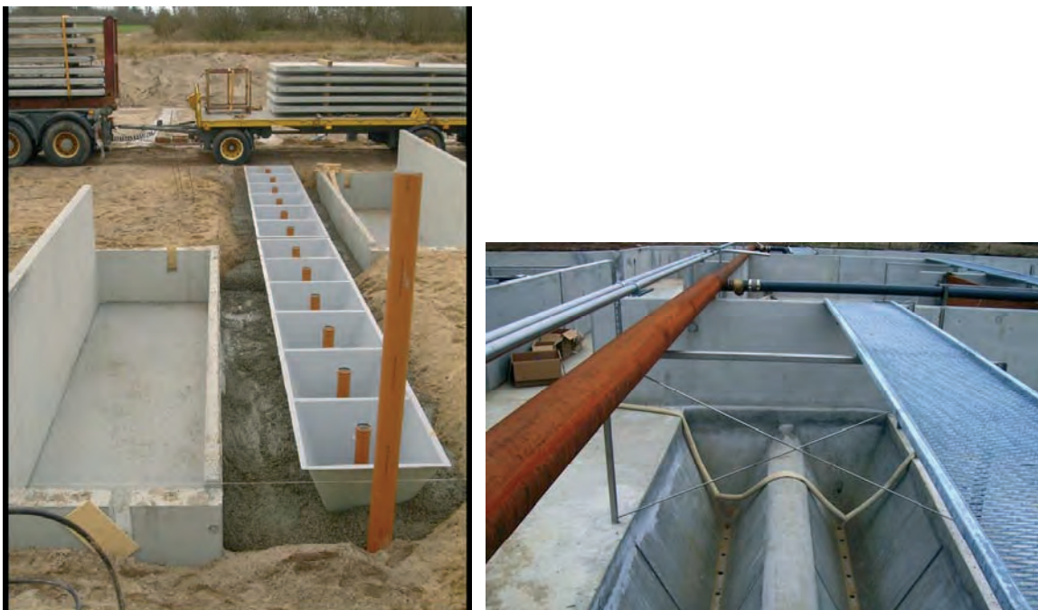
Figur 17. Slamkegler er placeret nedstrøms i hver raceway sektion i fuld bredde af bassinet og i niveau med bassinbunden. Til venstre har hver raceway 6 separate slamkegler, mens bassinet til højre har én slamrende i dets fulde bredde med kun et afløb. Foto: Lars M. Svendsen og Lisbeth J. Plesner.
