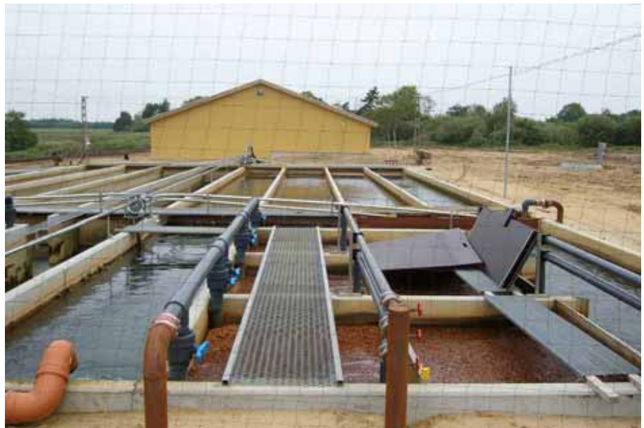
Foto 16.2.3.5 Sættefiskeanlægget ved Abildtrup Dambrug med kummehus i baggrund. Forrest ses plastikmediet i moving bed delen af biofiltret.
