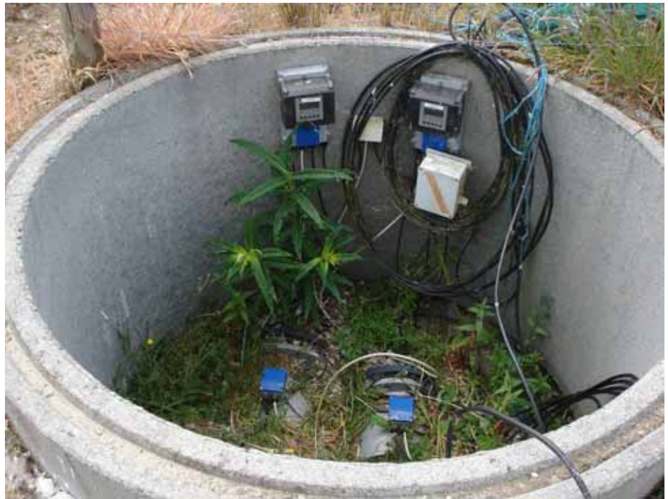
Figur 16.1.4.1 Flowmålere vandure (i bunden af brønden) og tilhørende display monteret på indersiden af brøndring. Monteret i brøndring for at beskytte målerne mod trafik og for meget vandpåvirkning.
